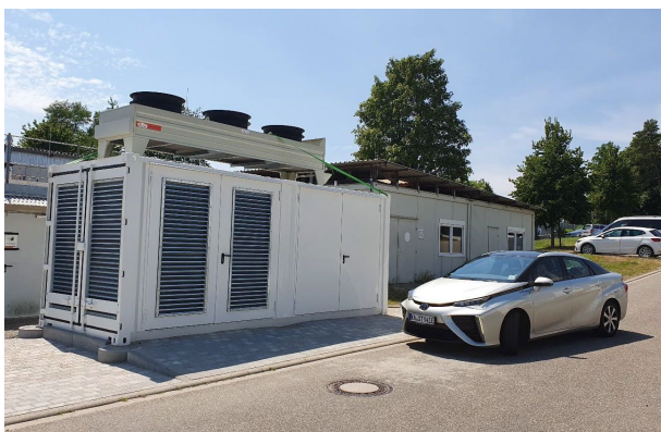
Рис. 5. Металлогидридный термосорбционный компрессор (30–450 бар, 22,5 нм 3 /ч) в составе водородной заправочной станции, разработанный в рамках проекта ЕС «COSMHYS»
